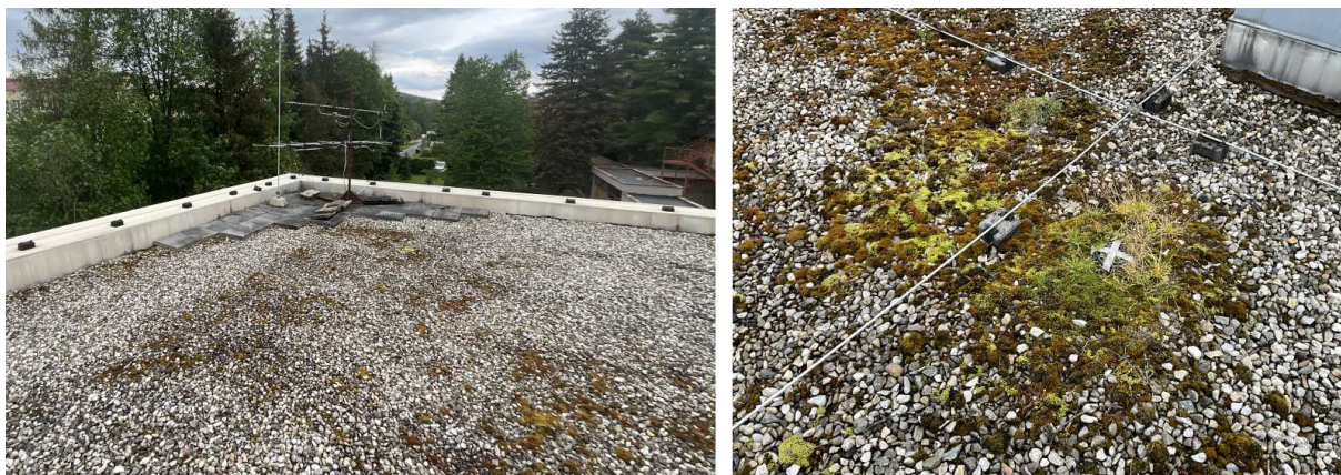
pohled na střeche, u obvodu patrná vyšší vrstva kačírku; zarůstající vpust
