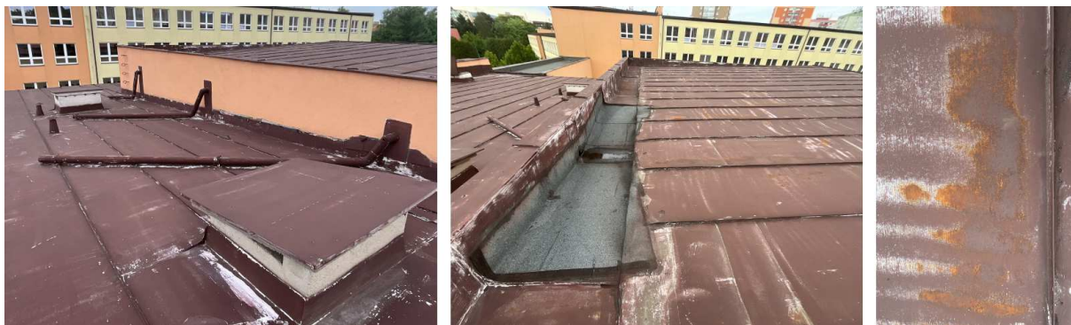
způsob vyvedení svodů; oprava prorezlého žlabu; stav krytiny
