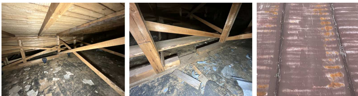
konstrukce pultových střech v napojení různých výšek; uložení na podklad; stav střešní krytiny
