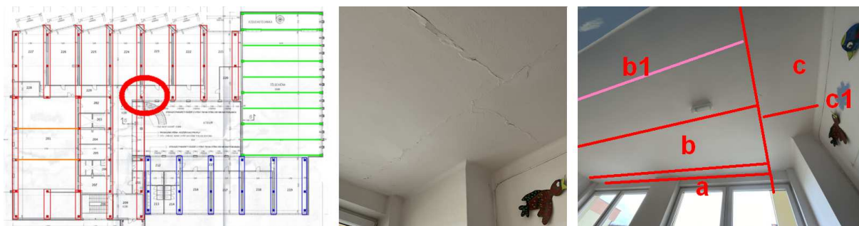
poloha poškození; a - obvodový poval; b - panel; c - průvlak; c1 - styčník průvlaků; b1 - u druhého panelu již spára bez poruchy
