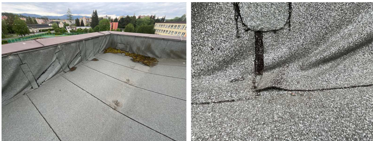
nedostatečně kotvená hydroizolace na atikách; detail vznikajících poruch v deformovaných místech
