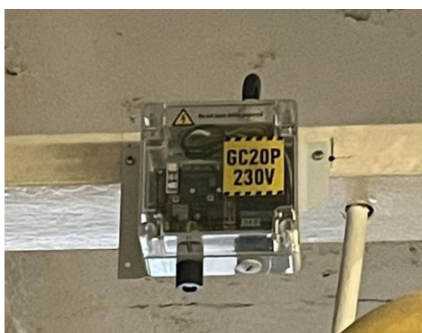
Foto č. 13 - detektor úniku plynu v kotelně
