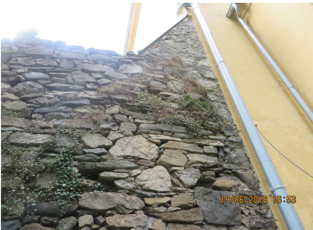
Obr. 14 Zeď Z5 – detailní pohled na pravou část hradby, poruchy X1, X2
