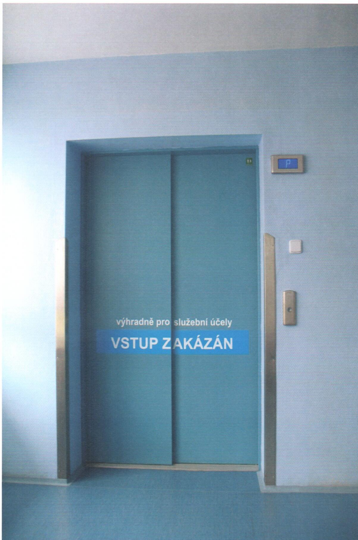
FOTOGRAFIE VÝTAHU (V1) – výměna provedena v roce 2010
