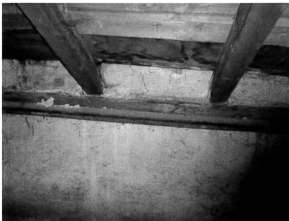
foto/41/ Pohled na stopy po zatečení
