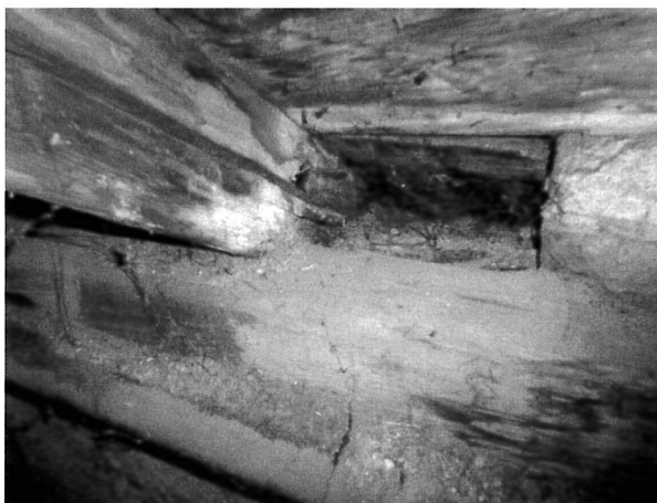
foto/39/ Pohled na poškozené uložení krokve
