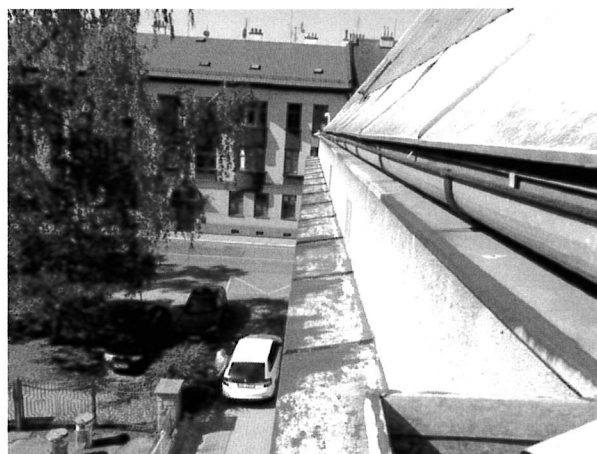
foto/31/ Pohled na podokapní žlab a zkorodovanou okapnici
