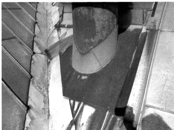
foto/18/ Pohled na vstup a zkorodované oplechování
