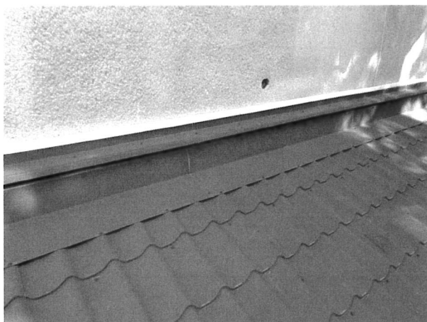
foto/50/ Pohled na oplechování konstrukce s průběžným větracím otvorem
