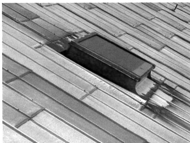
foto/20/ Pohled na výlez a zkorodované oplechování
