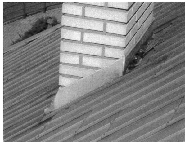
foto/21/ Pohled na oplechování komína
