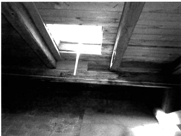
foto/40/ Pohled na stopy po zatečení
