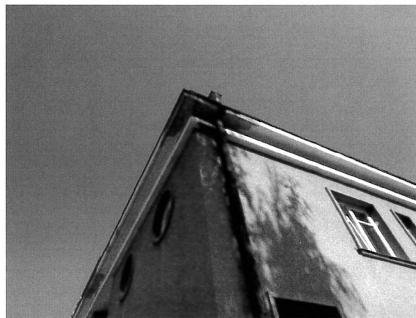
foto/5/ Pohled na odpadávající omítku a vlhkostní poruchy na fasádě objektu
