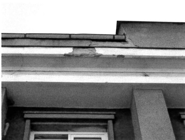
foto/4/ Pohled na odpadávající omítku a vlhkostní poruchy na fasádě objektu
