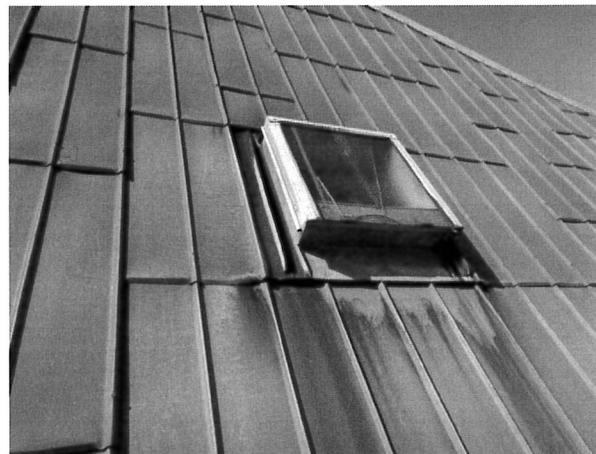
foto/19/ Pohled na výlez a zkorodované oplechování
