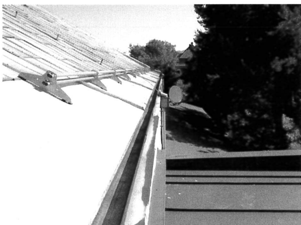
foto/30/ Pohled na podokapní žlab a zkorodovanou okapnici
