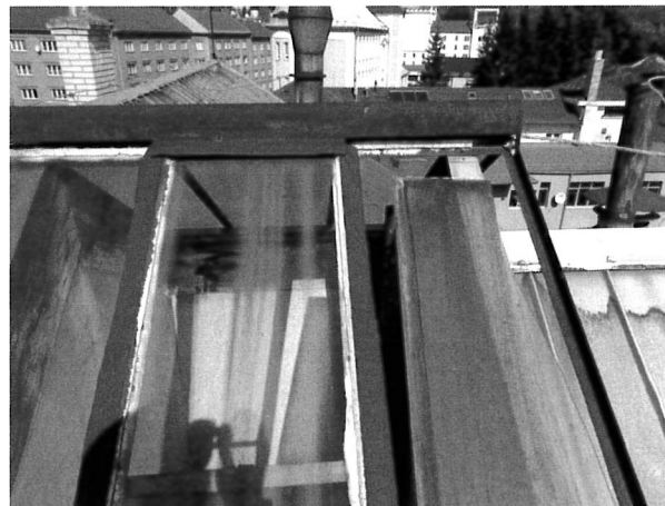
foto/23/ Pohled na vyjetou skleněnou tabuli
