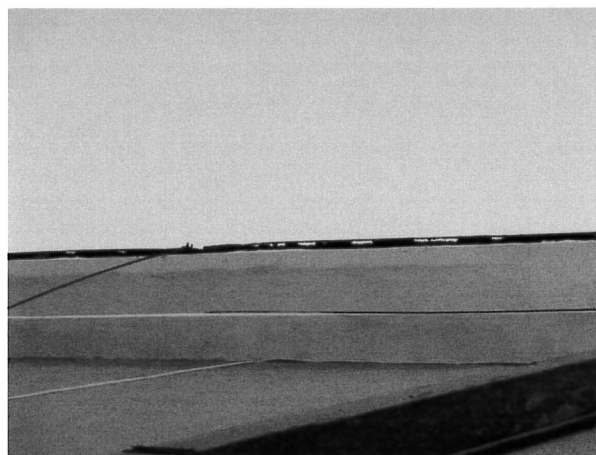
foto/35/ Pohled na děravou okapnici
