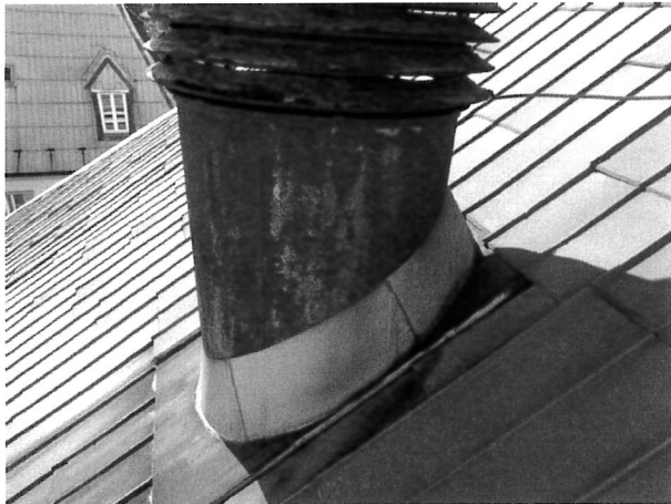
foto/16/ Pohled na vstup a zkorodované oplechování
