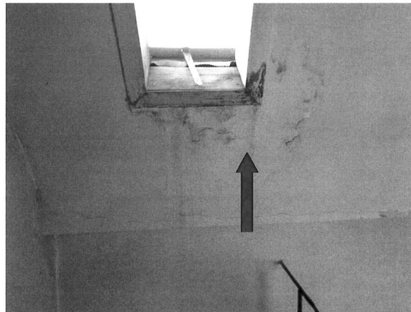
foto/3/ Pohled na vlhkostní poruchy okolo střešního výlezu
