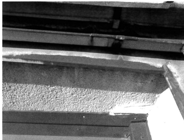
foto/33/ Pohled na zkorodovanou okapnici
